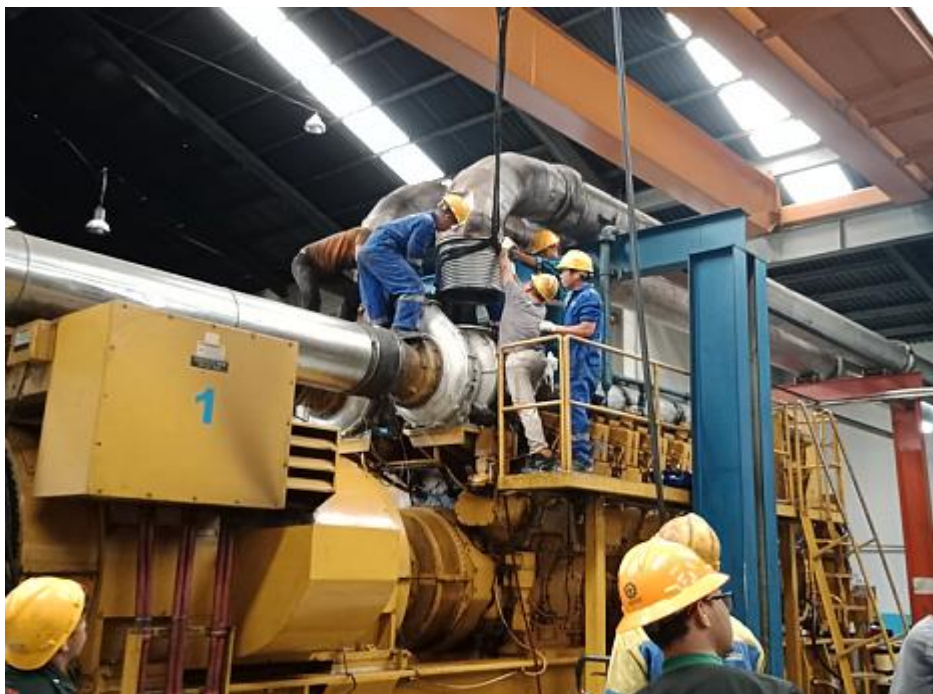
Gambar 2.2 Pemeliharaan Caterpillar Engine Generator
