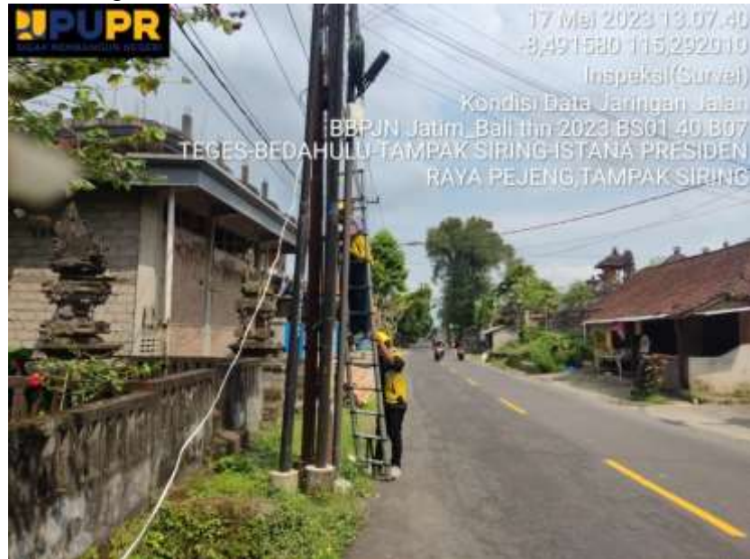
Gambar 2. 25 Pemasangan CCTV BS 3
