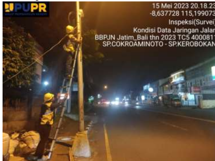
Gambar 2. 13 Pemasangan CCTV TC 5
