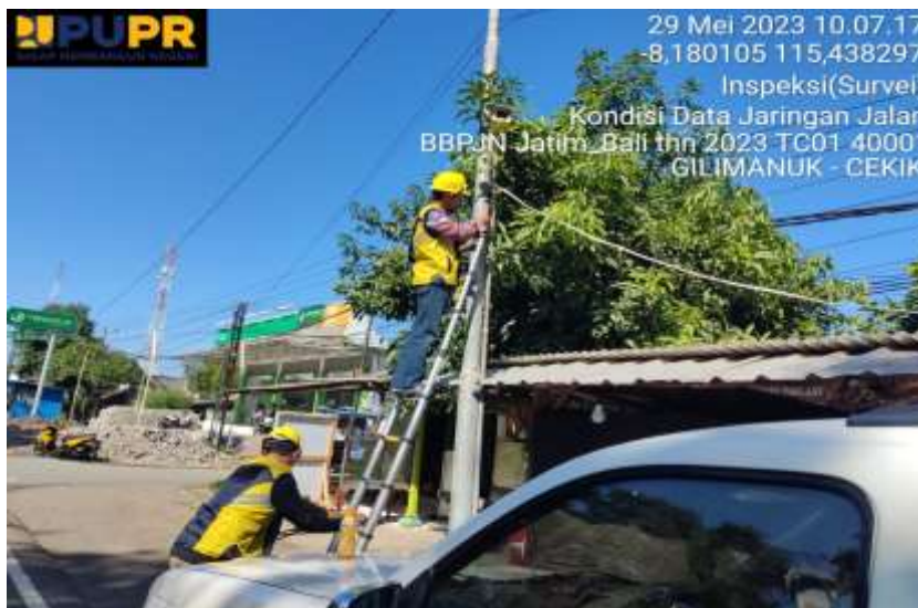
Gambar 2. 1 Pemasangan CCTV TC 1
