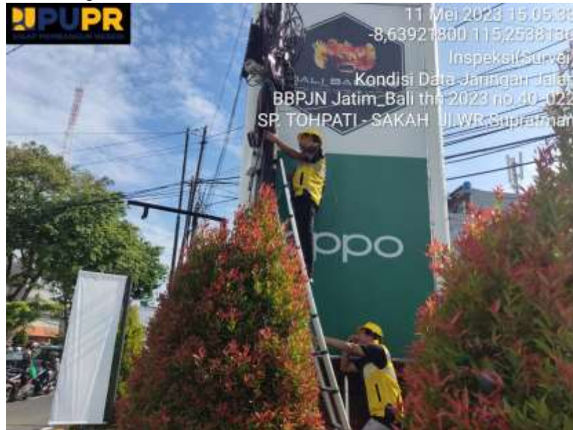
Gambar 2. 21 Pemasangan CCTV BS 2
