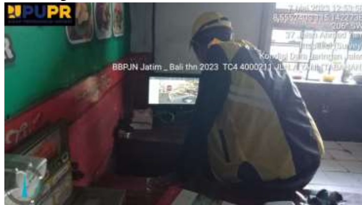
Gambar 2. 11 Pemasangan Monitor CCTV TC 4
