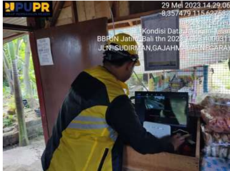
Gambar 2. 8 Pemasangan Monitor CCTV TC 3
