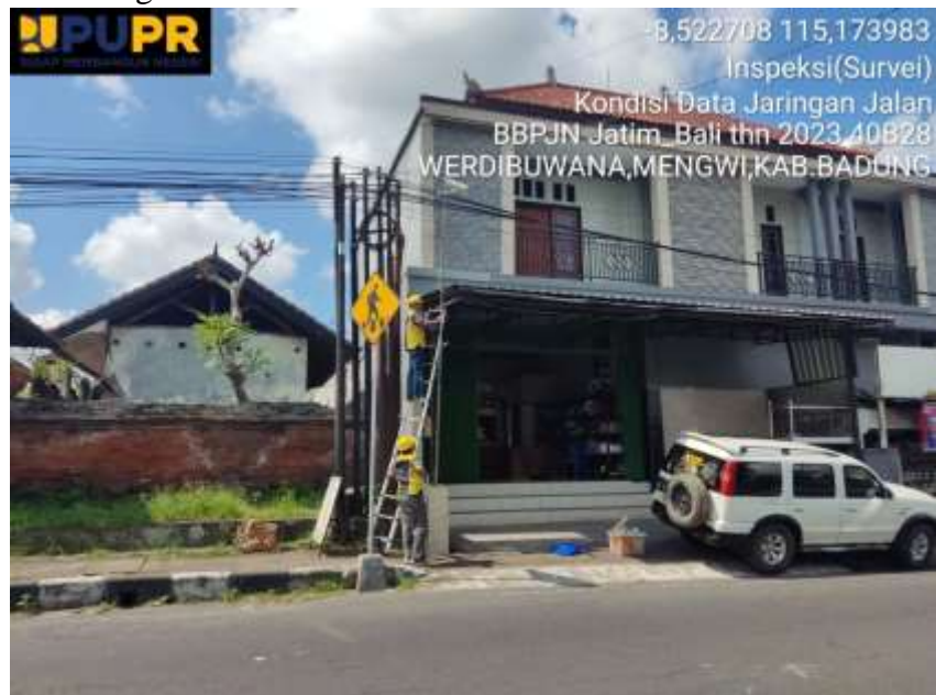
Gambar 2. 30 Pemasangan CCTV BS 4
