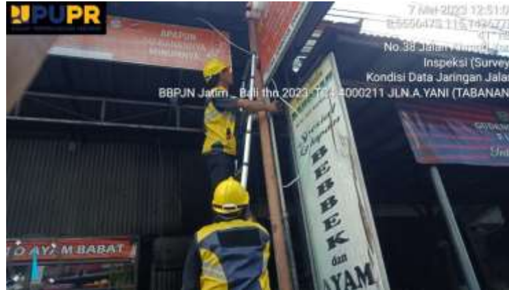
Gambar 2. 10 Pemasangan CCTV TC4
