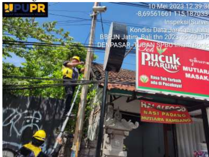
Gambar 2. 16 Pemasangan CCTV BS 1
