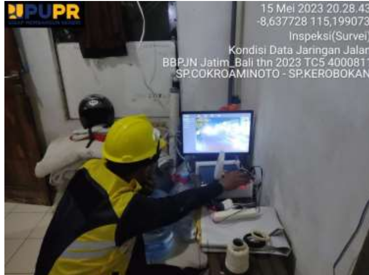
Gambar 2. 14 Pemasangan Monitor CCTV TC 5
