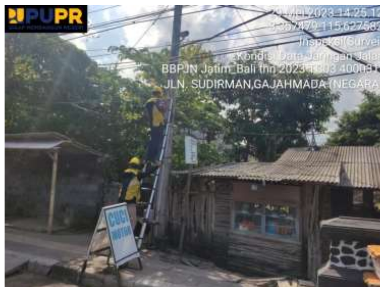
Gambar 2. 7 Pemasangan CCTV TC 3
