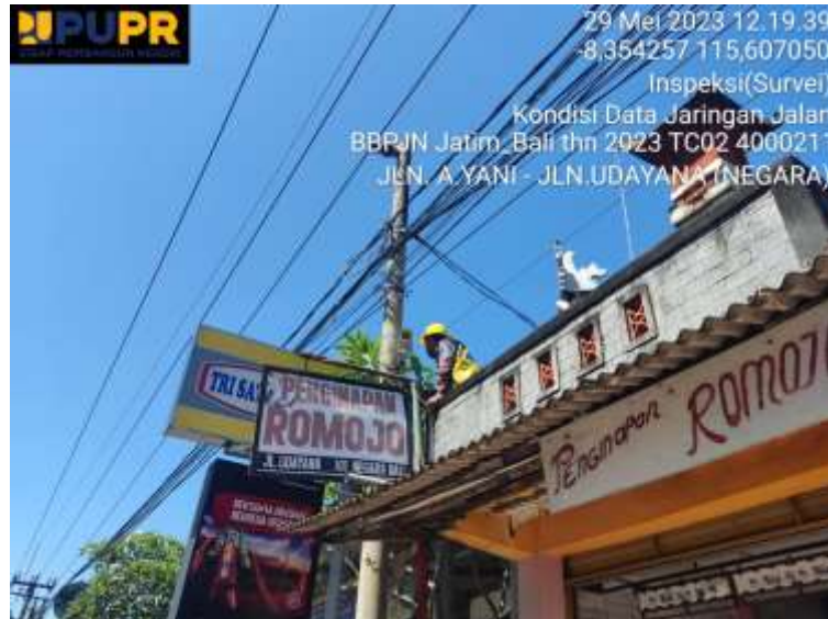
Gambar 2. 4 Pemasangan CCTV TC
