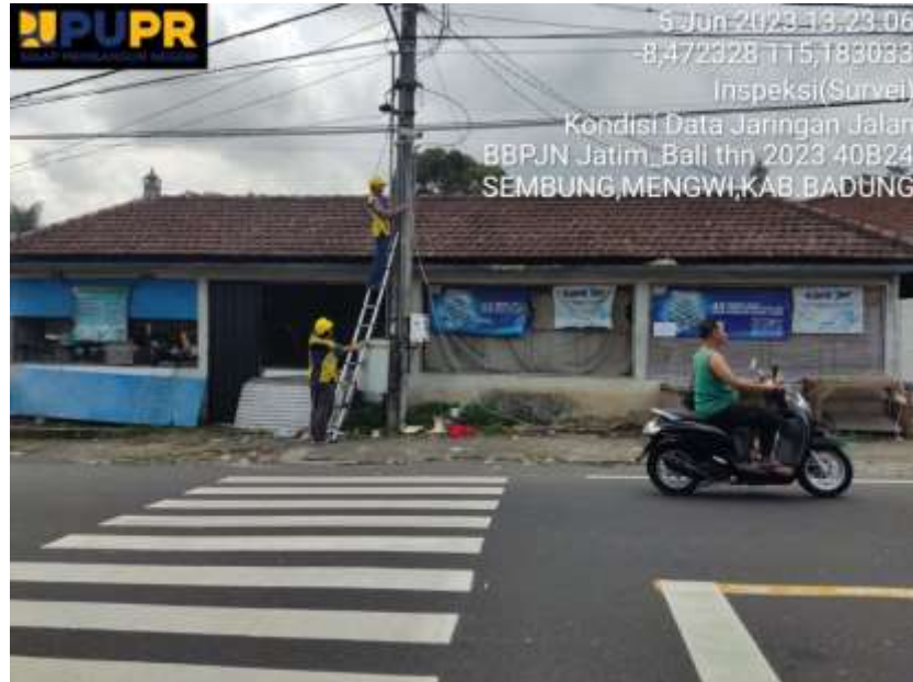
Gambar 2. 35 Pemasangan CCTV BS 5
