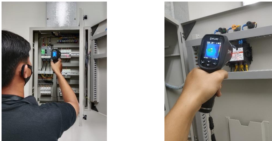
Gambar 2.4 Pengecekan Temperatur Panel
