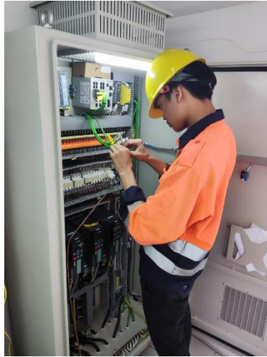
Gambar 2.4 wiring panel PT. Sumber Indahperkasa
