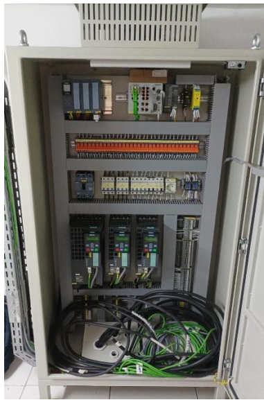
Gambar 2. 6 Kondisi kabel di Panel PLC sebelum dirapihkan
