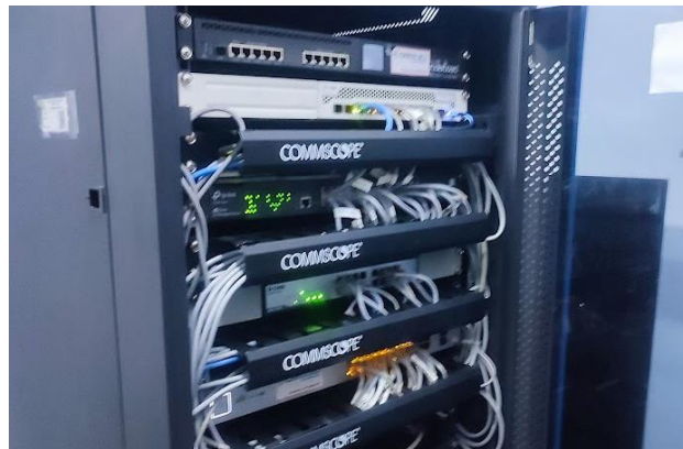
Gambar 1.26 Kunjungan Ruang Server
